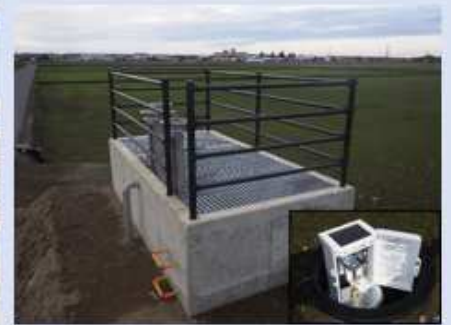
調整水槽・自動給水栓
