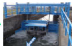
発電施設 (設置後)
